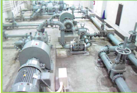
小那覇増圧ポンプ設備
